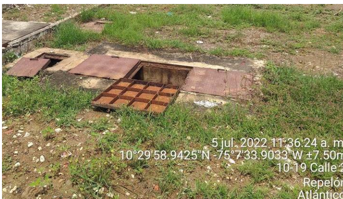
Fotografía No. 3 - Tercera cámara, está conformada por dos compartimentos, en la parte inferior se encuentra el falso fondo del filtro anaeróbico FAFA (Filtro Anaeróbico de Flujo Ascendente) y Campo de infiltración en el Suelo.
